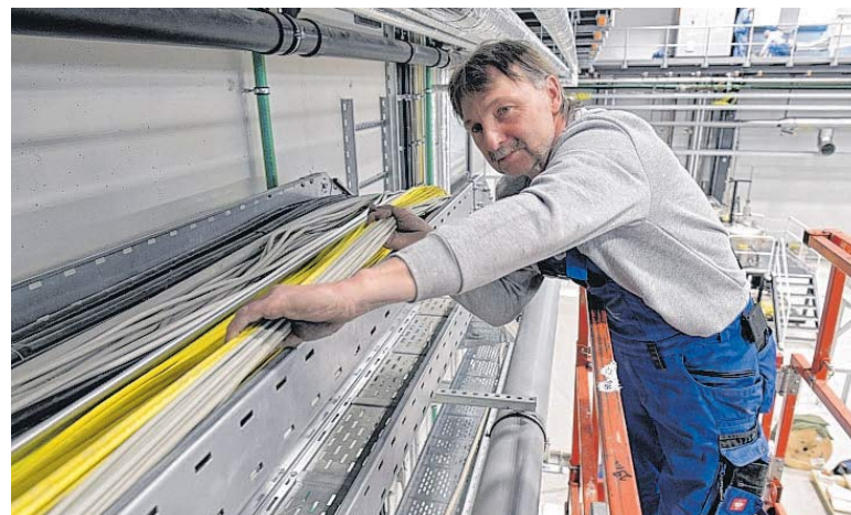
Jürgen Brunzel von der Firma Rendke aus Großenhain verlegt Kabel in der Halle. Neben der Stromversorgung muss auch der Datenfluss funktionieren.
